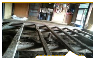
床下の泥出しは大変な重労働
